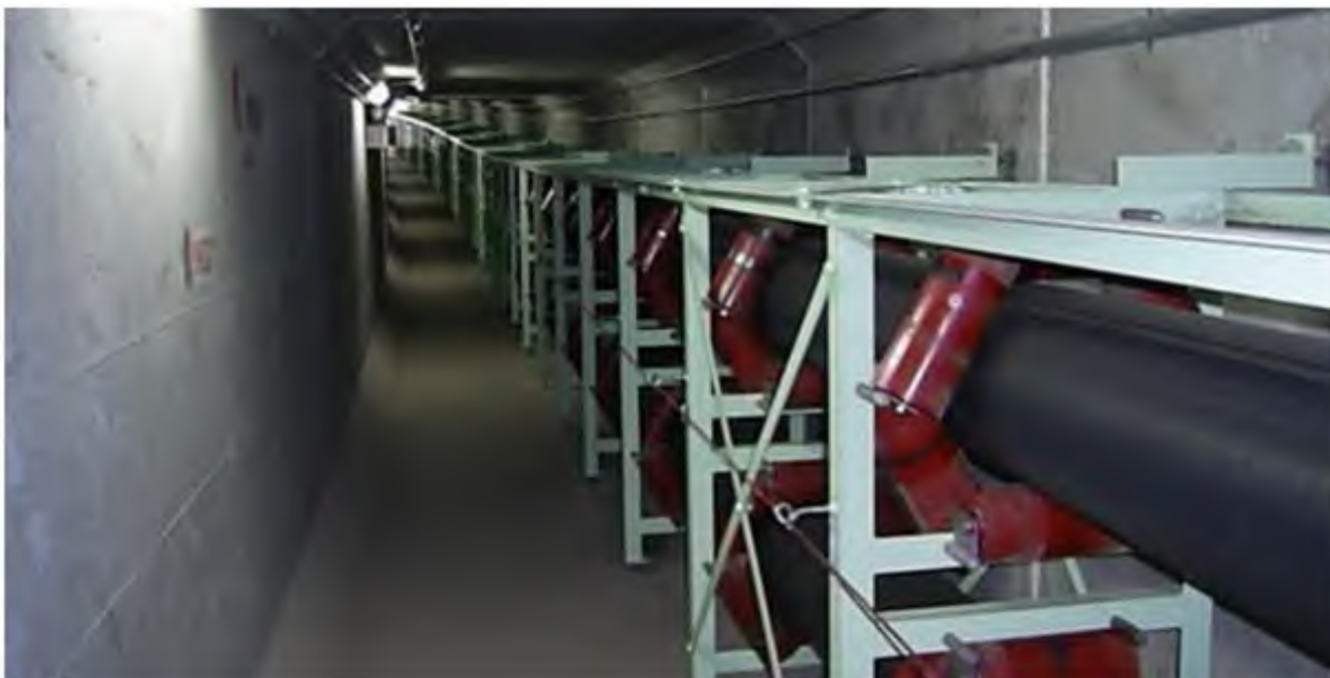
Figure 9 : Exemple de convoyeur tubulaire dans un tunnel
